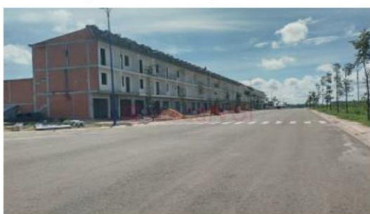
Dự án: Nhà liền kề, lô 16, KCN Bình Phước, huyện Chợ Thành, Bình Phước
